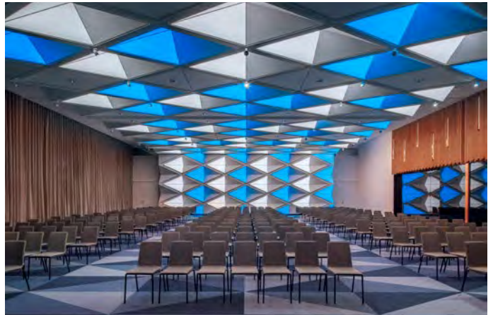
Abb.: Hinter den LED-Spanndecken im Ballroom befinden sich RGBW-LED-Stripes, damit lässt sich jede gewünschte Farbe einstellen. Ebenso ist weißes Licht von warmweißen 3.000 K bis kaltweißen 6.500 K möglich.
